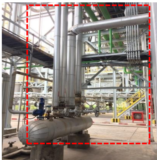
รูปที่ 2.60 ท่อส่งจ่ายไอน้ำ
