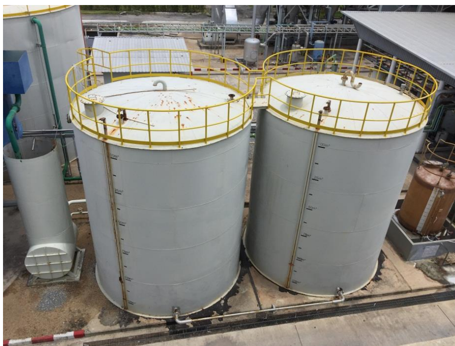
รูปที่ 2.30 ถังพักน้ำปราศจากอิออนใช้ป้อนหม้อน้ำ (Demineralized water)
