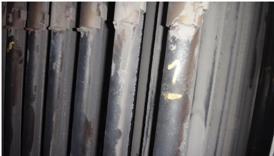
รูปที่ 10.65 สภาพท่อ Low Temp. Superheater Tube
