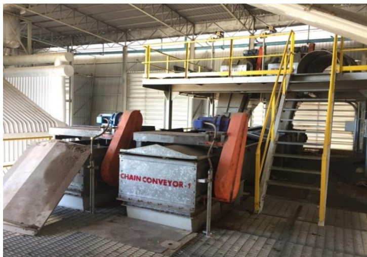
รูปที่ 2.43 สะพานโซ่ลำเลียงเชื้อเพลิงหน้าหม้อน้ำก่อนป้อนลงช่องเชื้อเพลิง
