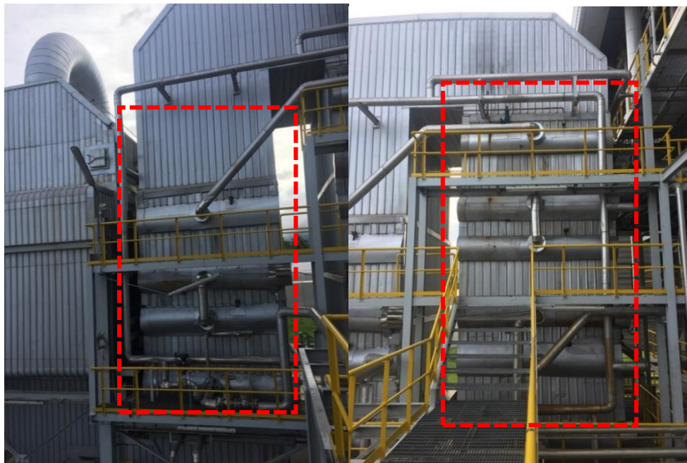
รูปที่ 2.59 ชุดอุ่นน้ำป้อนหม้อน้ำ (Economizer)
