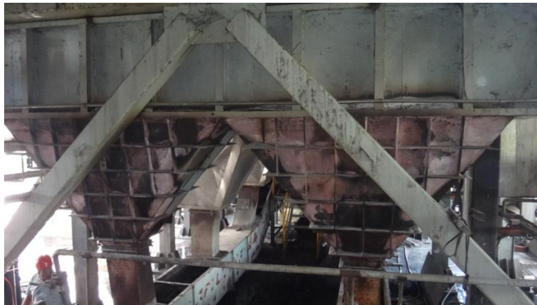
รูปที่ 10.30 Wet Ash Chain Coveyor No.1 และ 2
