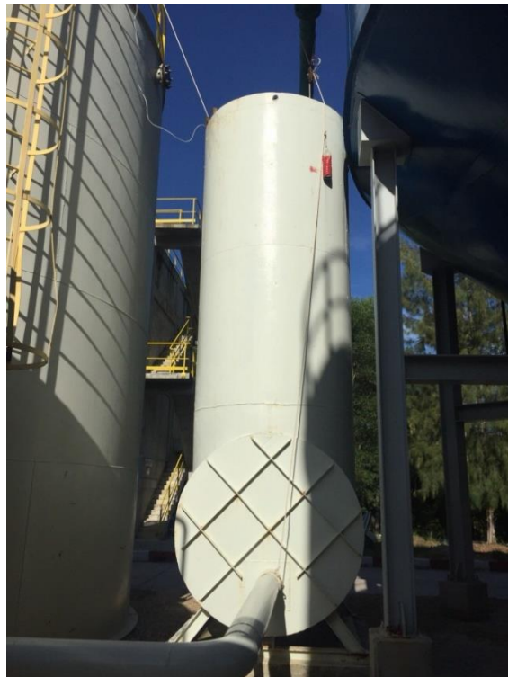
รูปที่ 2.20 ถังพักน้ำกรองใส (Clear water storage tank)
