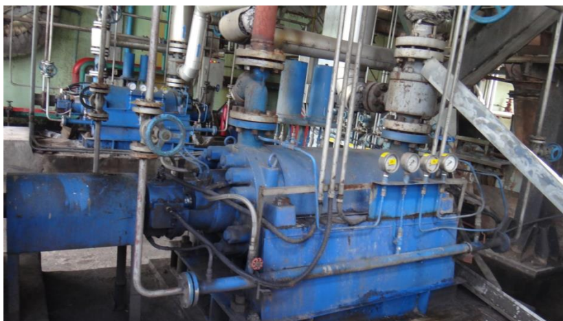
รูปที่ 10.51 Boiler Feed Water Pump
