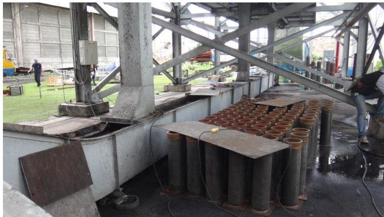
รูปที่ 10.32 Fly Ash Chain Conveyor ลำเลียง Fly Ash จาก ESP
