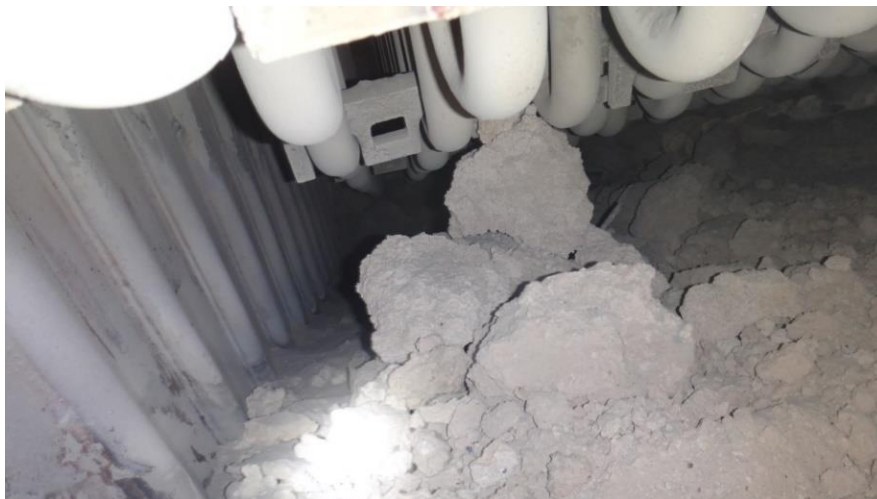
รูปที่ 10.66 สภาพท่อ Low Temp. Superheater Tube
