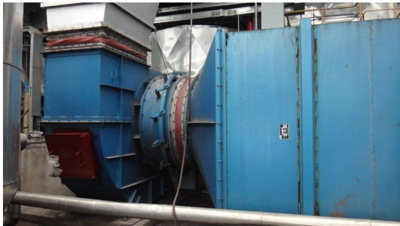
รูปที่ 10.42 Forced Draft Fan (FD. Fan)
