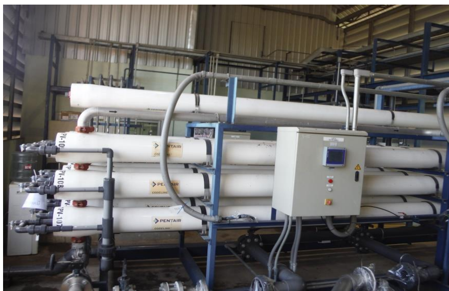
รูปที่ 10.8 อุปกรณ์ของระบบ Water Treatment
