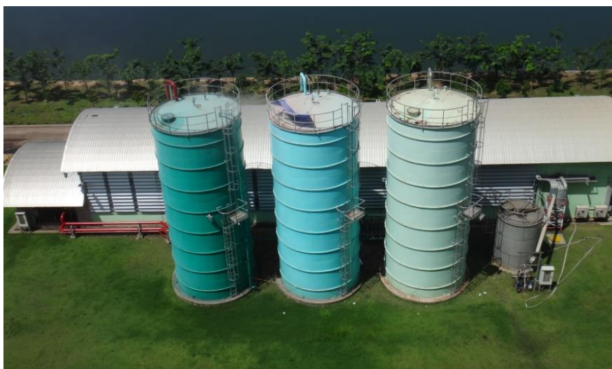
รูปที่ 10.7 ระบบผลิตน้ำ Water Treatment Plant
