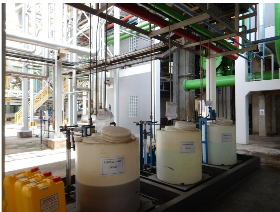
รูปที่ 2.31 ระบบเติมสารเคมีก่อนเข้าถังดีแอโรเตอร์ (Deaerator tank) และชุดเติมสารเคมีเข้าดรัมของหม้อน้ำ (Boiler Drum)
