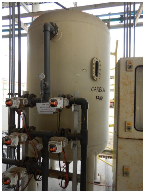
รูปที่ 2.24 ถังกรองผ่านถ่าน (Carbon filter column)
