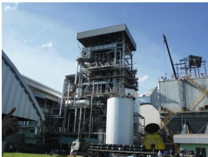
รูปที่ 10.1 Bagasse Fire Boiler
