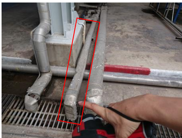
(ค) Steam trap รั่วสติก่อนเข้าถัง Deaerator
