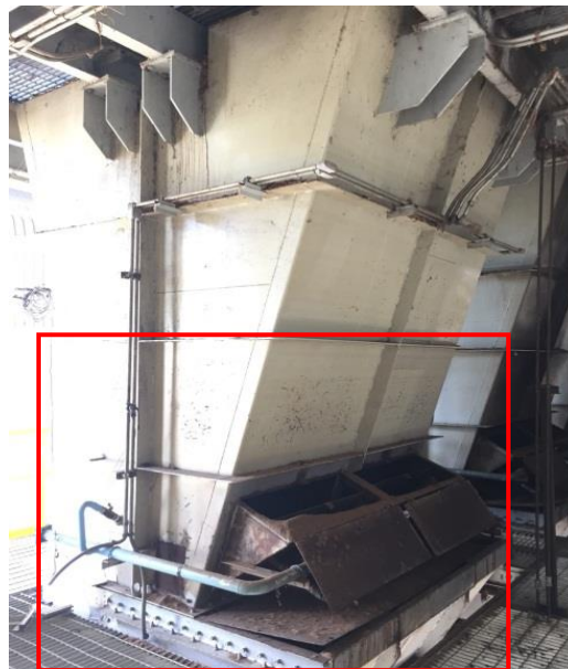
รูปที่ 9.59 บริเวณที่เกิดปัญหาการติดขัดเชื้อเพลิงภายใน Silo fuel
