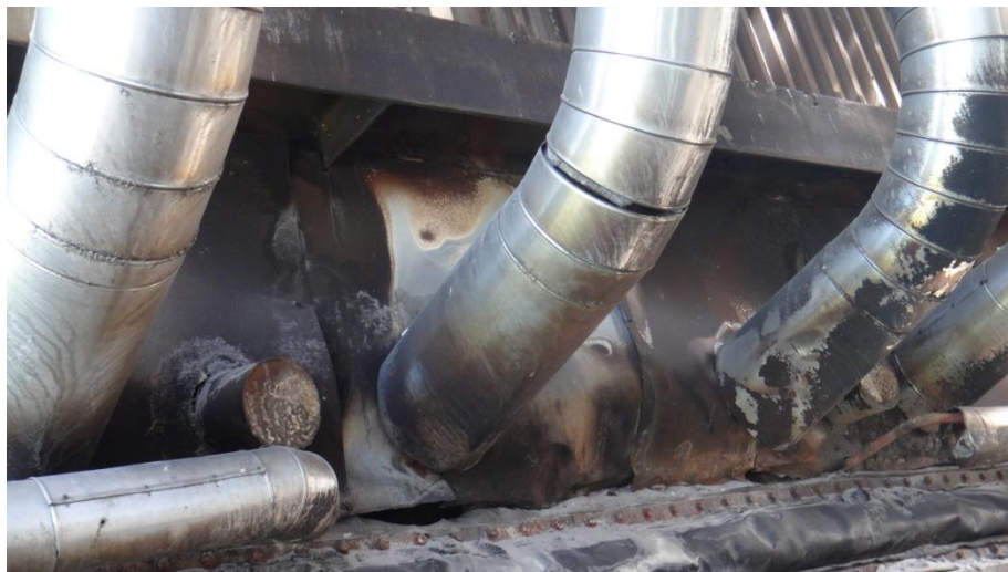
รูปที่ 10.12 สภาพ Insulation และ Lagging มีรอยไหม้
