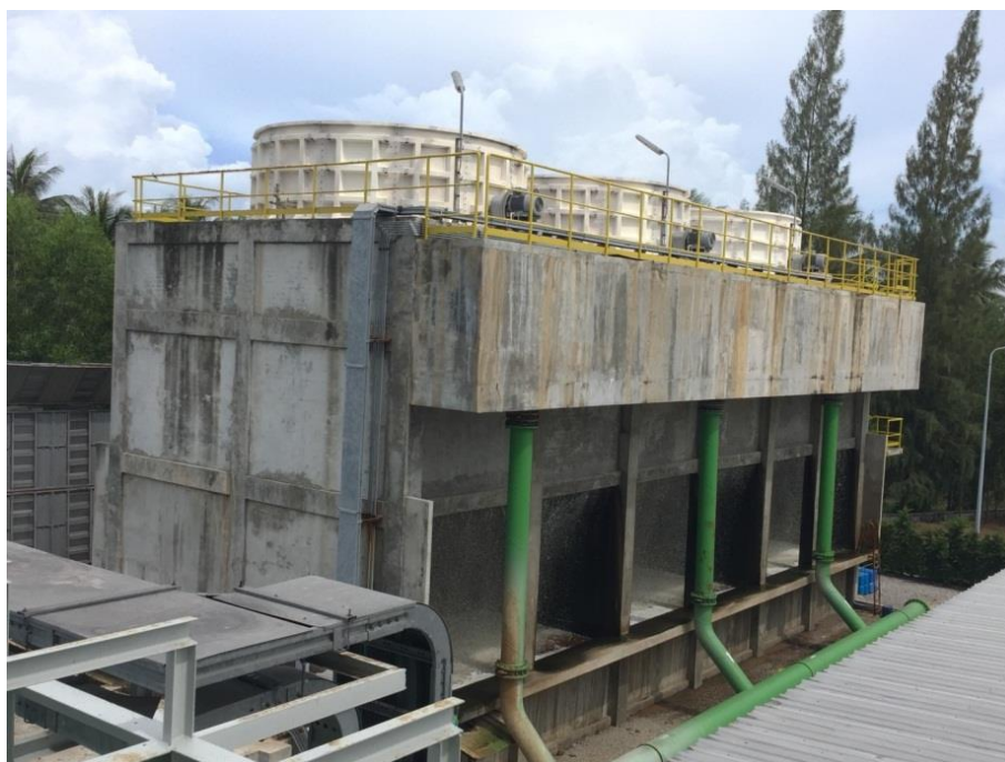
รูปที่ 2.64 หอผึ่งเย็น (Cooling Tower)
