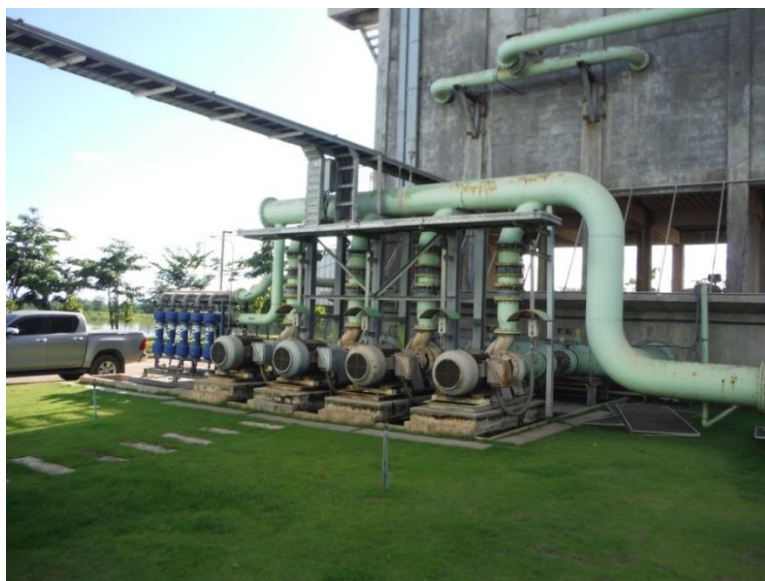
รูปที่ 10.55 ระบบอุปกรณ์ Main Water Cooling Pump
