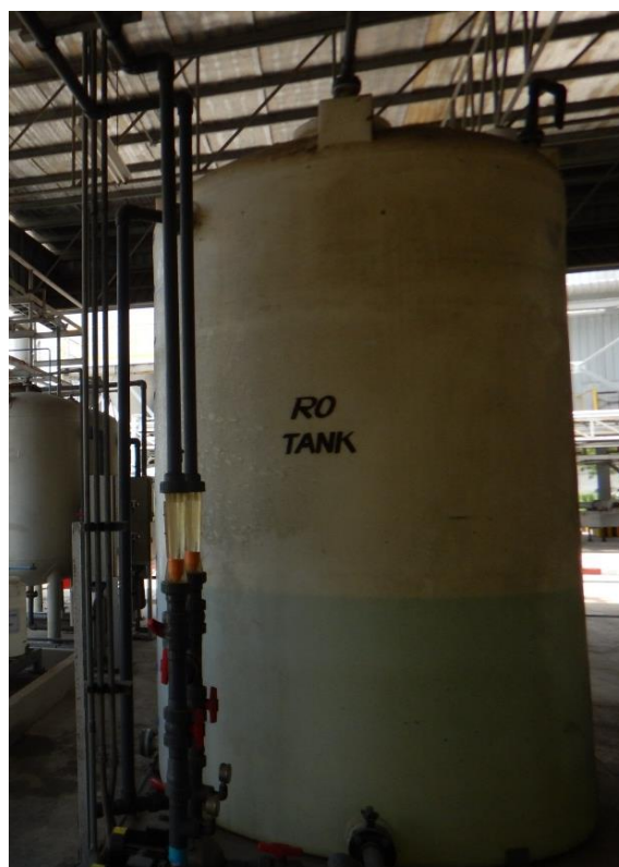
รูปที่ 2.28 ถังพักน้ำ RO (RO water storage tank)
