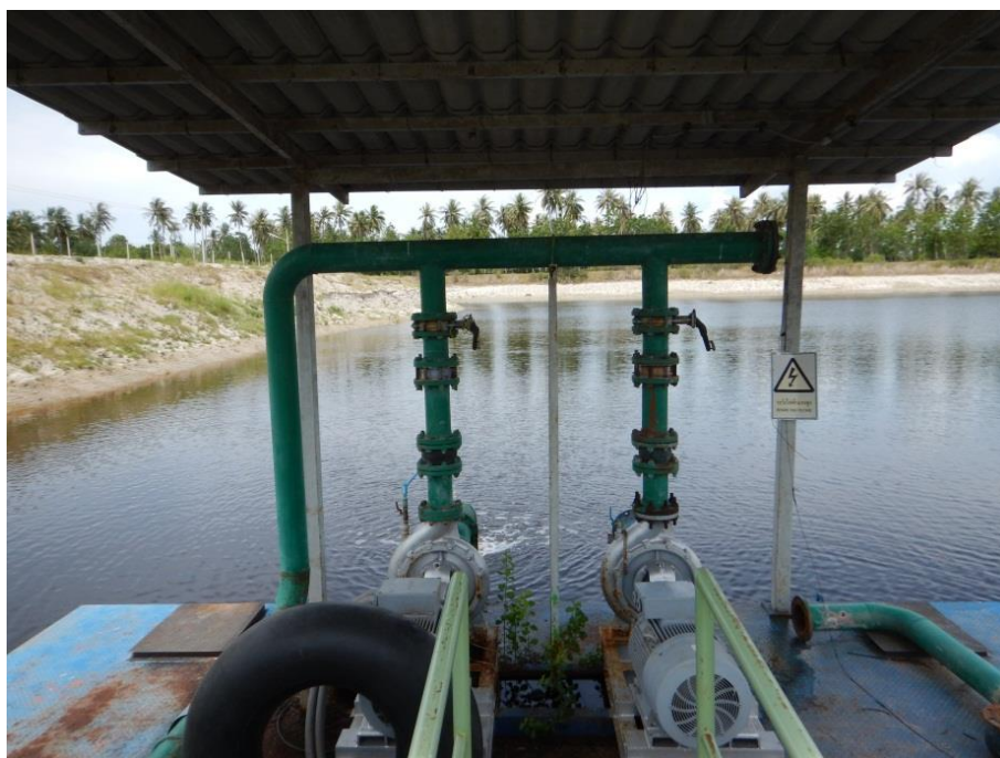
รูปที่ 2.17 ปั๊มน้ำดิบ (Raw water pump)
