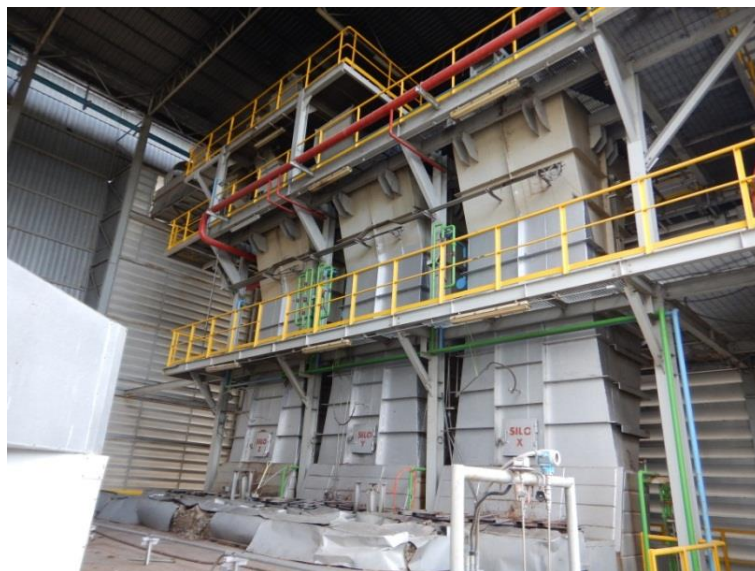
รูปที่ 2.45 ซองเชื้อเพลิง (Silo) ก่อนเข้าสู่ชุดป้อนเชื้อเพลิงเข้าหม้อน้ำ
