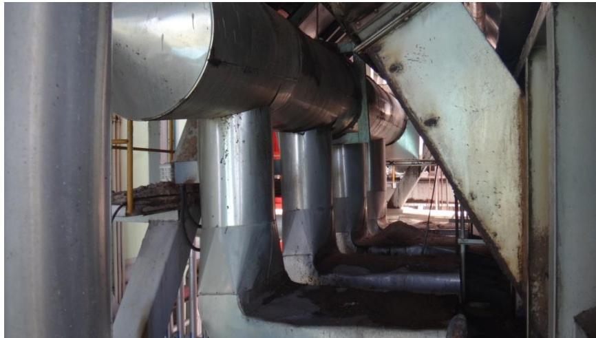
รูปที่ 10.20 พบเศษฝุ่นเชื้อเพลิงหล่นลงบริเวณ Feeding Air Piping
