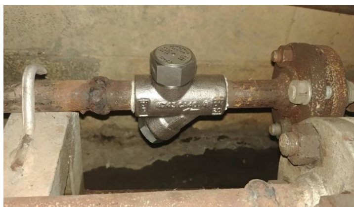
รูปที่ 5.15 กับดักไอน้ำที่อุณหภูมิเหมาะสมก่อนเข้าเครื่องกังหันไอน้ำขนาด 3 MW
