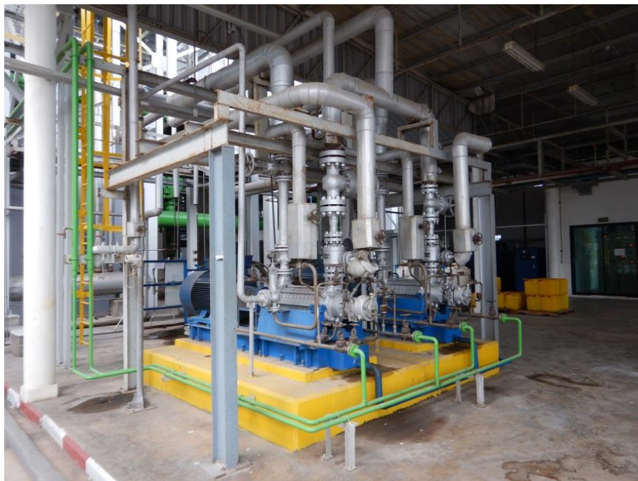
รูปที่ 2.58 ปั๊มน้ำป้อนหม้อน้ำ (Feed water boiler)
