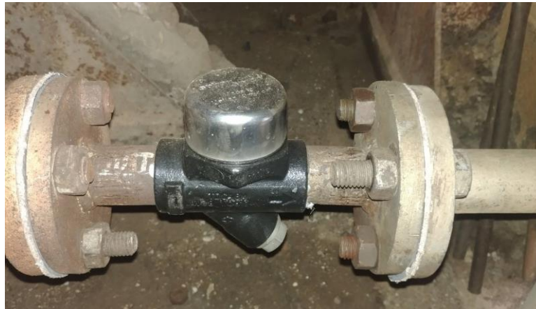
รูปที่ 5.16 กักดักไอน้ำท่อเมนสติก่อนเข้าเครื่องกังหันไอน้ำขนาด 5 MW
