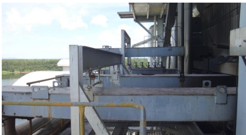
รูปที่ 10.27 Retracting Soot Blower ใช้ทำความสะอาดท่อบริเวณ Superheater Coil, Convection Bank
