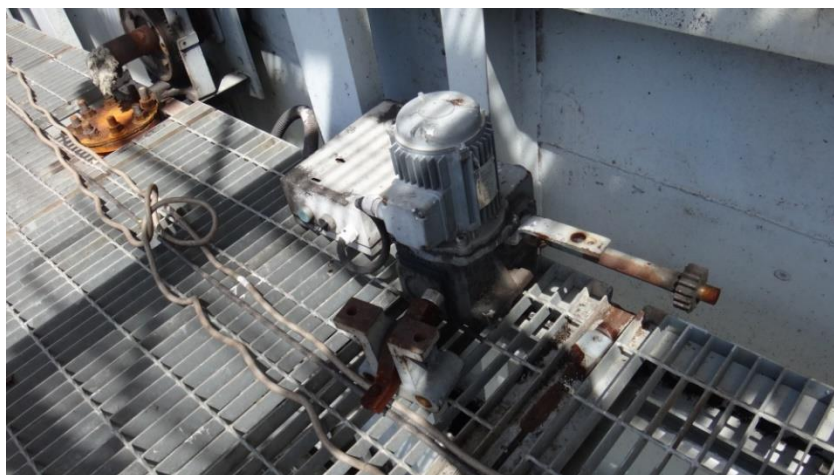
รูปที่ 10.29 Rotary Soot Blower ที่ถอดออกมา ยังไม่ได้แก้ไข
