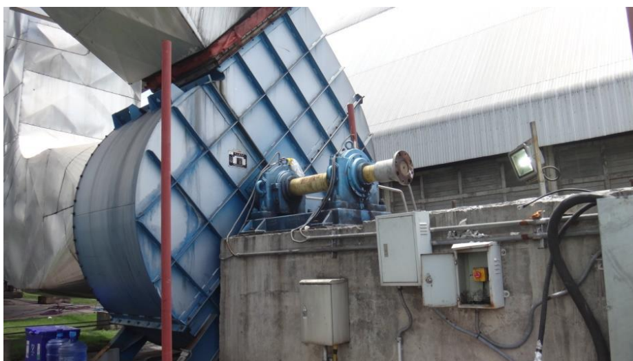
รูปที่ 10.45 Induced Draft Fan (ID. Fan)
