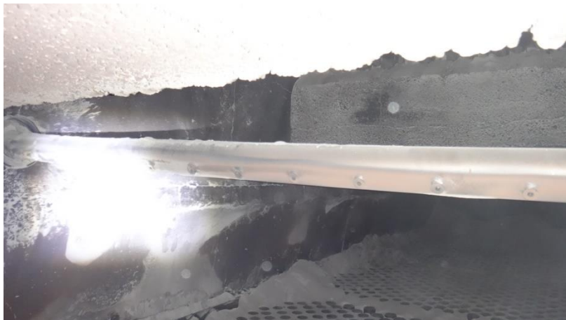
รูปที่ 10.72 สภาพรู Blowing Nozzle ของ Rotary Soot Blower
