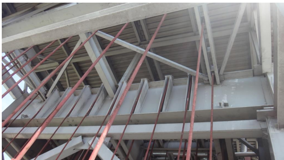
รูปที่ 10.11 ฐานยึดโครงสร้างหม้อน้ำ (Support Beam)
