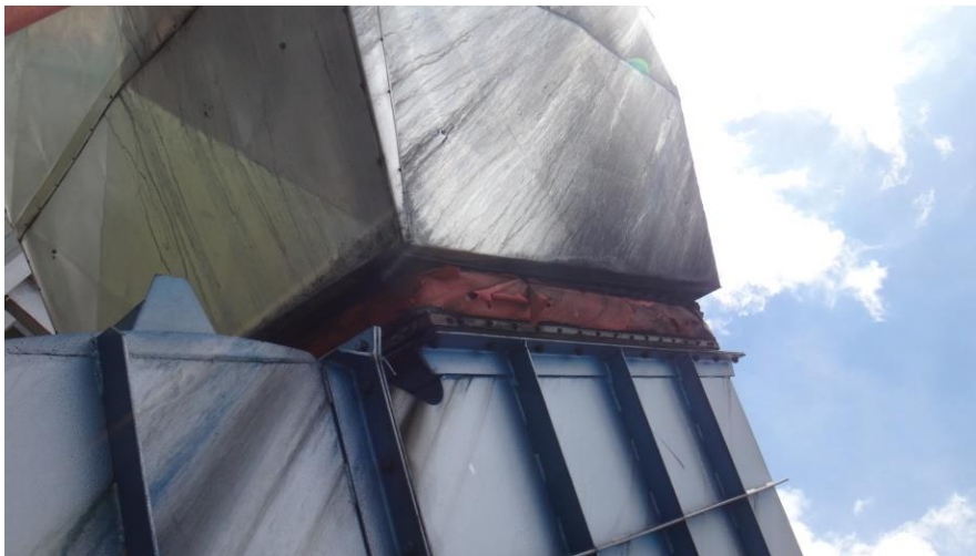
รูปที่ 10.46 Inlet/Outlet Expansion Joint of ID. Fan
