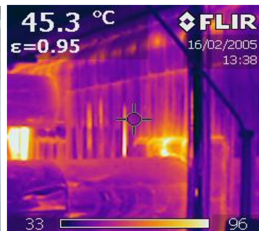
(ช) ภาพถ่ายความร้อนผนังด้านหลังหม้อน้ำ
