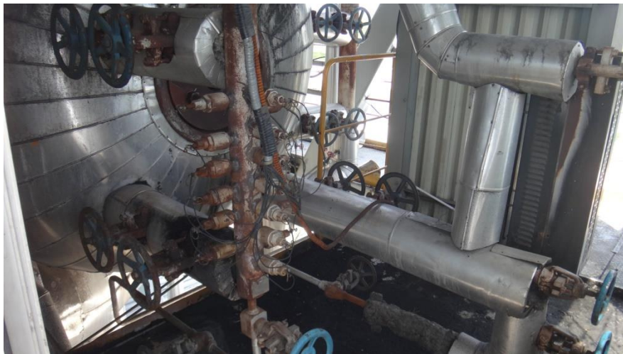
รูปที่ 10.14 Boiler Steam Drum และ Water Level Indicator ด้าน Left Side
