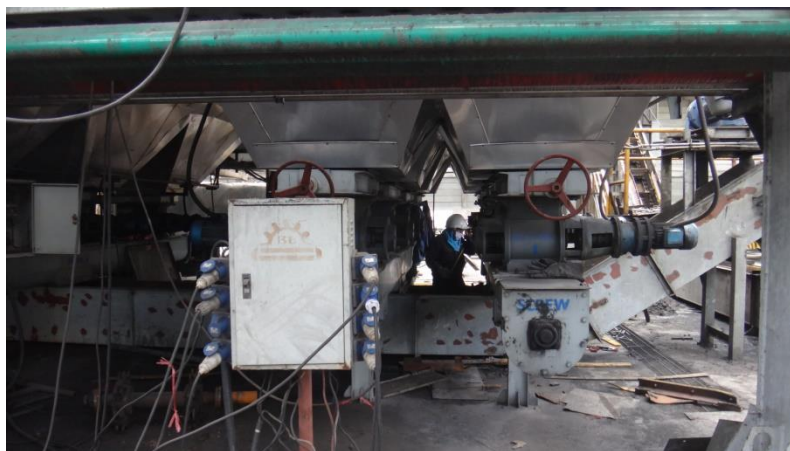
รูปที่ 10.31 Fly Ash Chain Conveyor ลำเลียง Fly Ash Multi-cyclone Dust Collector
