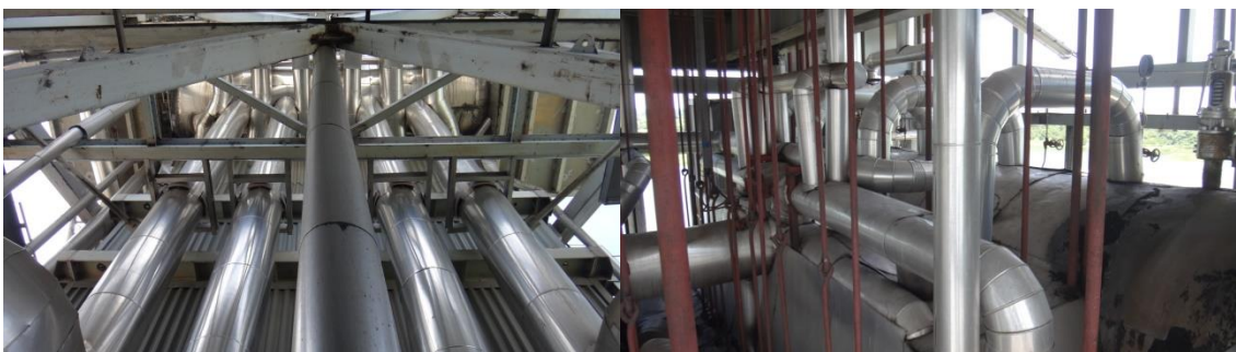
รูปที่ 10.37 สภาพของ Steam Piping
