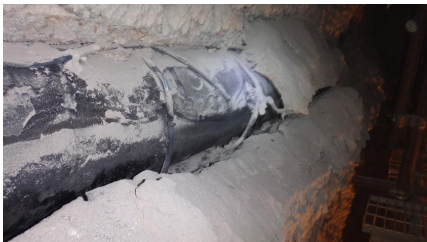
รูปที่ 10.24 สภาพปูนทนไฟมีการแตกร้าวและหลุดร่วง บริเวณ Expansion Joint
