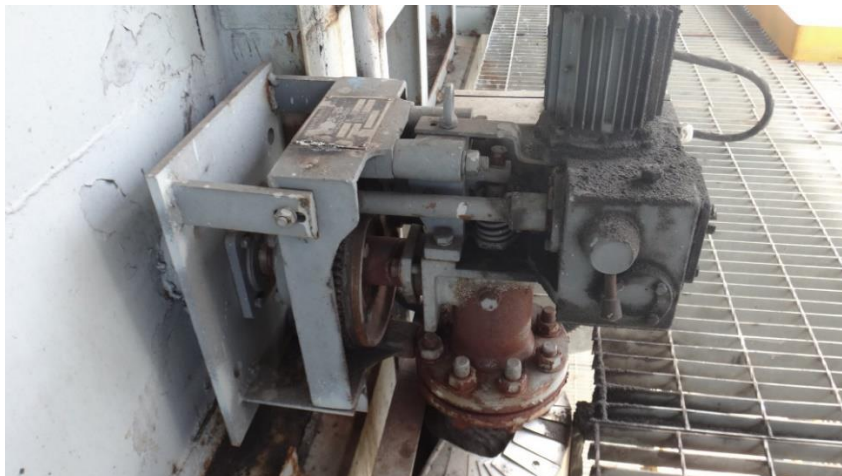
รูปที่ 10.28 Rotary Soot Blower ใช้ทำความสะอาดท่อ Economizer Tube และ Air Preheater
