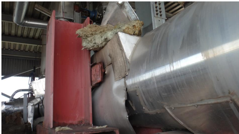
รูปที่ 10.38 ตำแหน่งที่ Steam Piping ไปเบียดกับฐานยึด (Piping Support)
