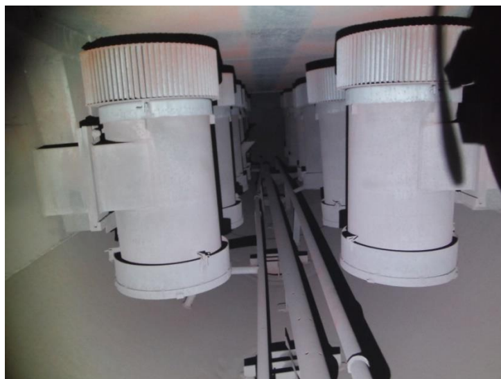
รูปที่ 10.74 สภาพ Turbo Cyclone Separator และอุปกรณ์ภายใน Boiler Steam Drum
