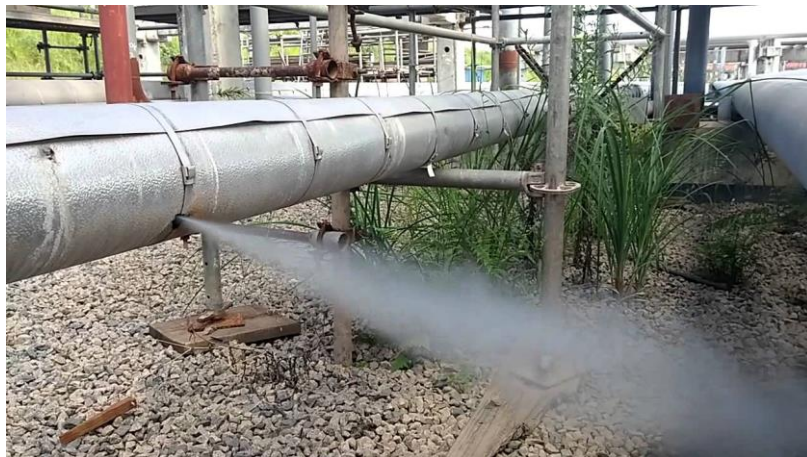
รูปที่ 5.2 ตัวอย่างการรั่วไหลของไอน้ำจากระบบท่อส่งจ่ายไอน้ำ
