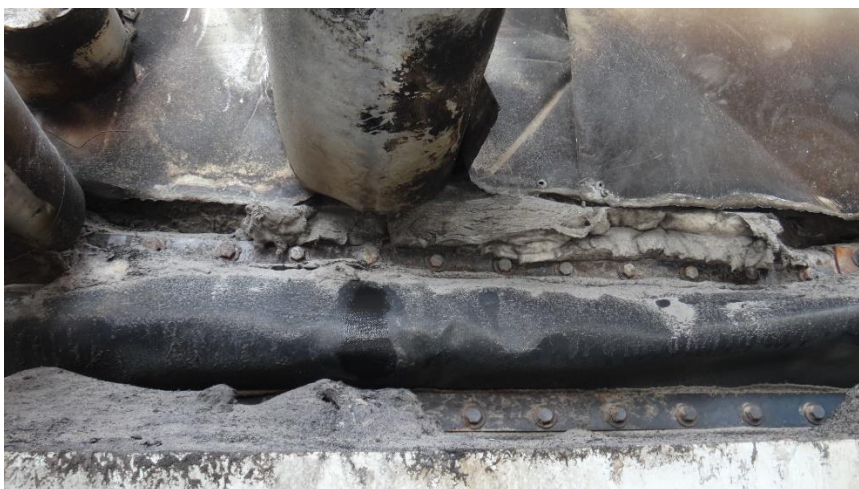
รูปที่ 10.26 สภาพ Insulation & Lagging บริเวณ Boiler Expansion Joint เกิดการชำรุดเสียหาย
