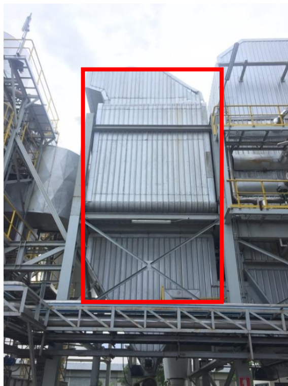
รูปที่ 2.53 ชุดอุ่นอากาศร้อน (Air preheater)
