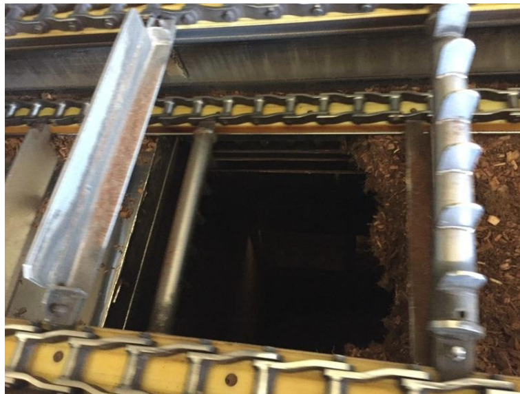
รูปที่ 2.44 บานประตูชักเพิ่ม-ลดเชื้อเพลิงได้สะพานลำเลียงเชื้อเพลิงหน้าหม้อน้ำ ทำงานด้วยระบบนิวเมติกส์
