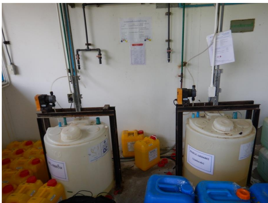
รูปที่ 2.18 ระบบเติมสารเคมีก่อนเข้าถังตกตะกอน
