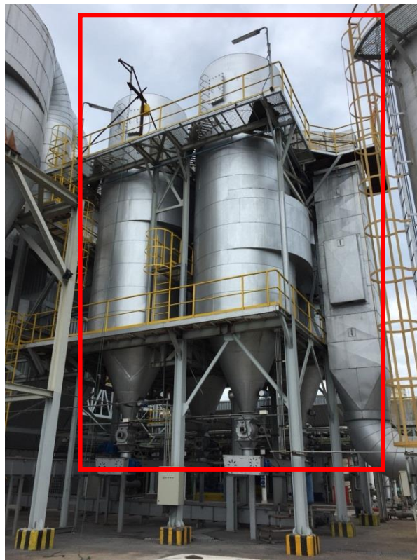
รูปที่ 2.69 ชุดตกซี้ไถ้ไอเสียระบบ Bag filter ก่อนปล่อยออกปล่่ง
