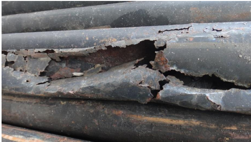
รูปที่ 10.71 สภาพท่อ Air Preheater Tube ที่เกิด Corrosion จนบางและทะลุ
