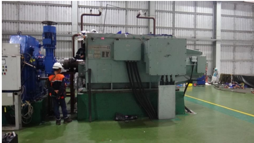
รูปที่ 10.58 สภาพอุปกรณ์ Generator
