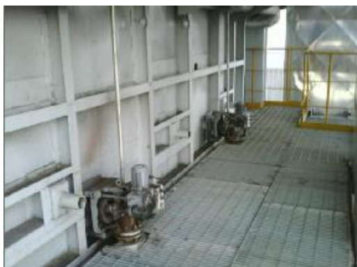
(จ) ผนังด้านข้างหม้อน้ำ
