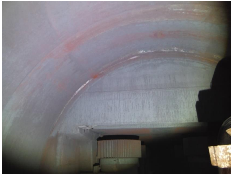
รูปที่ 10.73 สภาพแนวเชื่อมและผิวภายใน Boiler Steam Drum
