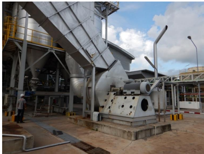
รูปที่ 2.71 พัดลมดูดก๊าซไอเสีย (Induced draft fan)
