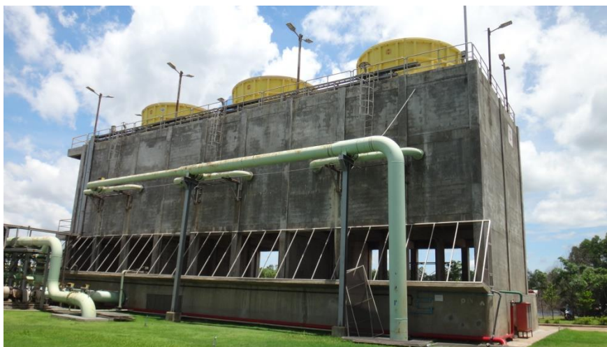
รูปที่ 10.53 ระบบอุปกรณ์ Cooling Tower Fan
