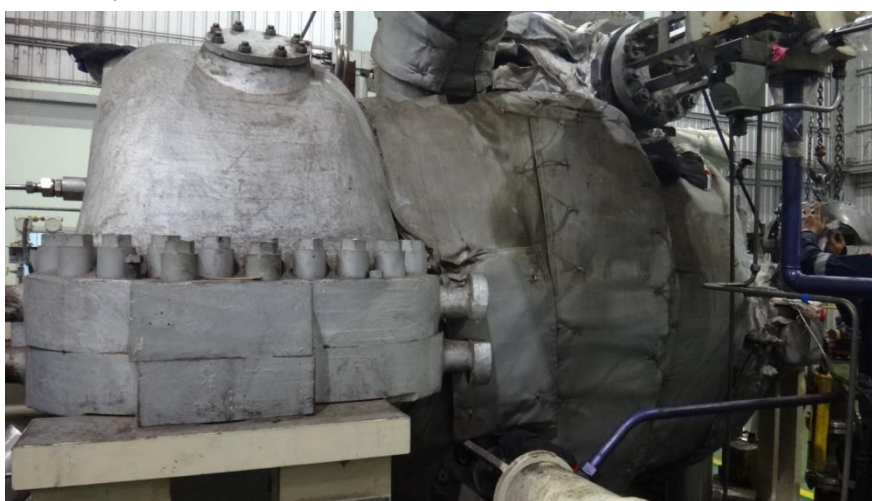
รูปที่ 10.56 Steam Turbine
