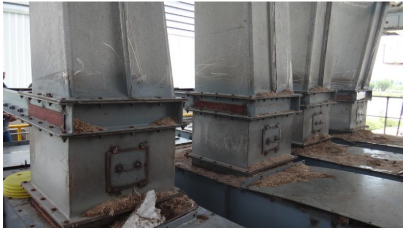
รูปที่ 10.18 Fuel Hopper และมี Feeder ทำหน้าที่ป้อนเชื้อเพลิงเข้าไปห้องเผาไหม้
