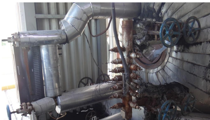
รูปที่ 10.15 Boiler Steam Drum และ Water Level Indicator ด้าน Right Side
