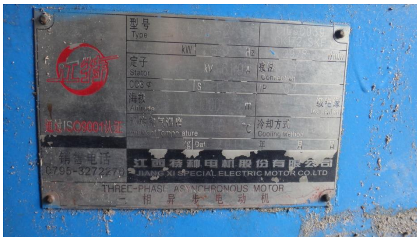
รูปที่ 10.52 Boiler Feed Water Pump name Plate
