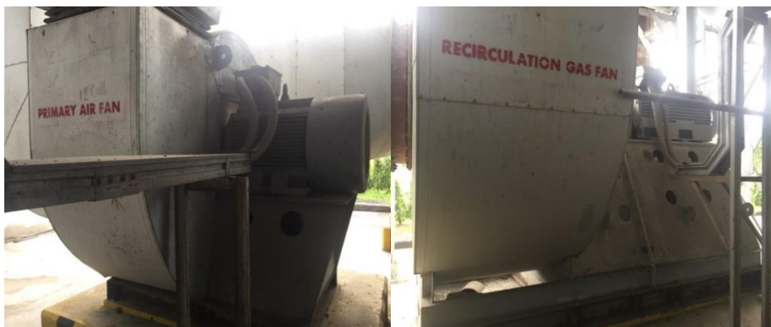
รูปที่ 2.54 พัดลมเป่า (Forced draft fan) ภาพซ้าย Primary air fan และพัดลมดูดไอเสียกลับมาเผาไหม้ (RGF) ภาพขวา Recirculation gas fan
