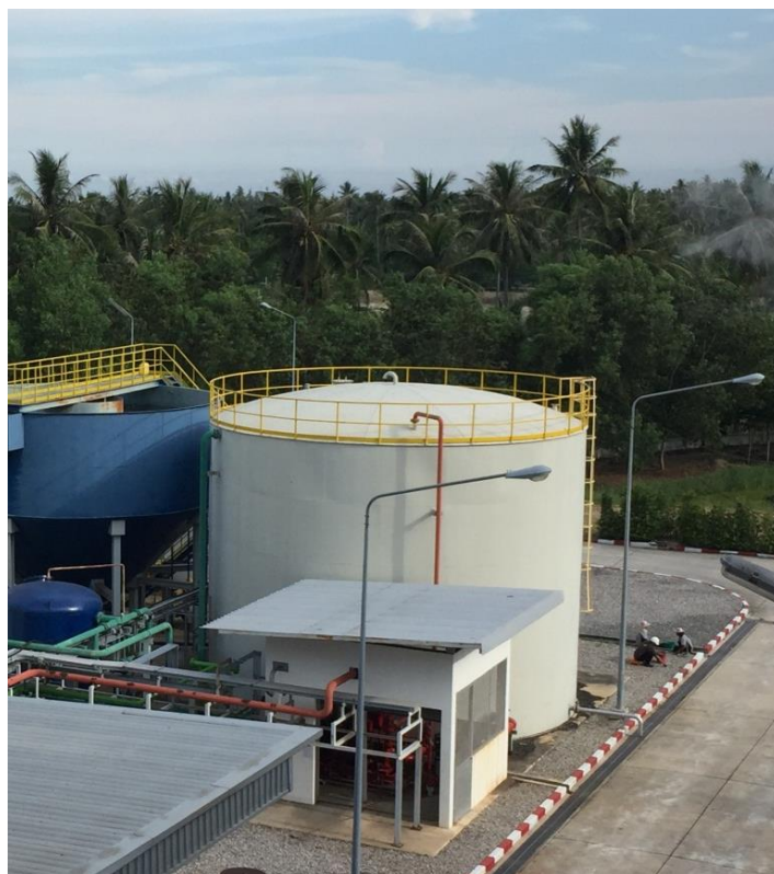
รูปที่ 2.22 ถังพักน้ำ Soft (Service water storage tank)
