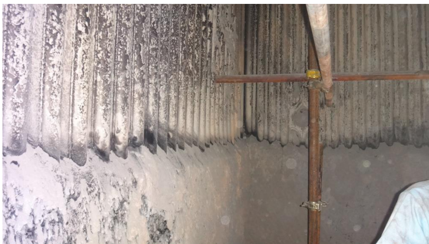
รูปที่ 10.60 ท่อ Water wall Tube บริเวณเหนือห้องเผาไหม้ (Furnace)
