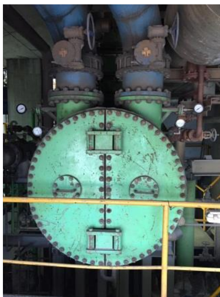
รูปที่ 2.63 เครื่องควบแน่น
